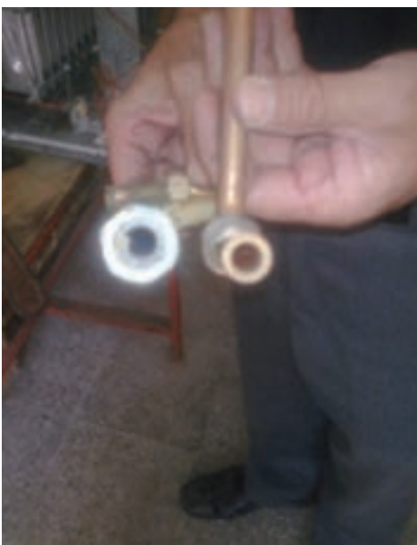
شکل ۱۲-۵- تشکیل رسوب در لوله آب گرم
