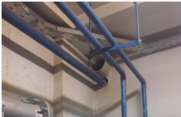
کانال تامین هوای موتورخانه از خارج ساختمان
