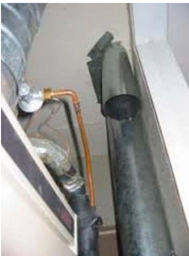
کانال قائم تامین هوای موتورخانه از سقف
